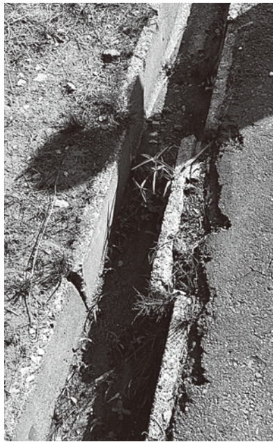
改修が待たれる側溝
