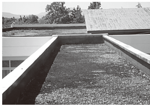
雨漏りしている校舎の屋根
