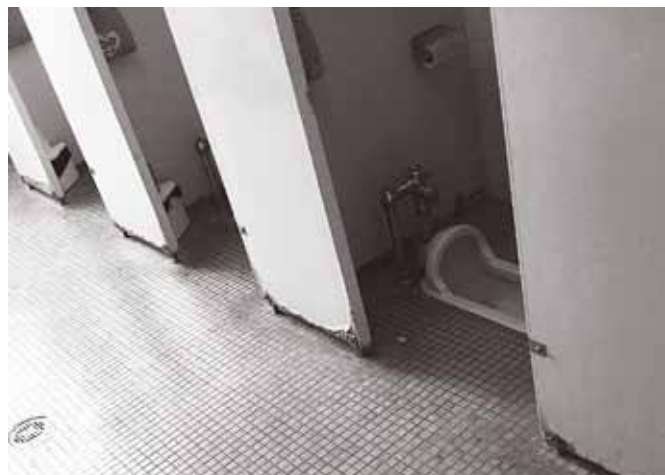
傷みが激しい学校のトイレ
